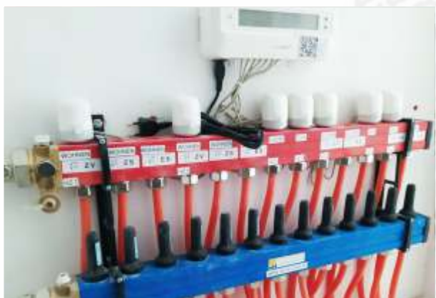
Angeschlossener Heizkreisverteiler mit Multizone
