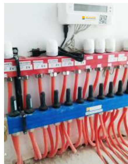
Angeschlossener Heizkreisverteiler mit Multizone
